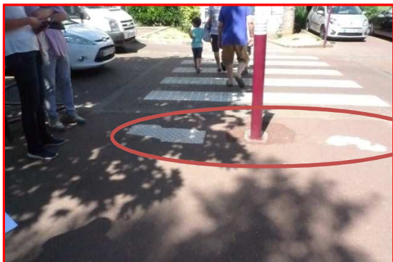
Bandes défectueuses ou inexistantes
